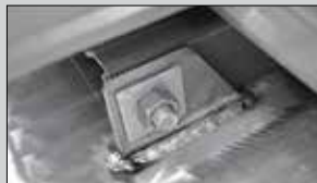
Enkel og solid innfesting av transformator.
