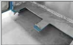
Dype utsparinger for kabler gir store bøyeradier på kablene både på høy- og lavspenningssiden.
