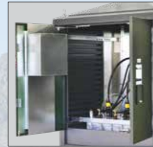
EKOM-SKAP Plassert i dør inn mot trafo.
