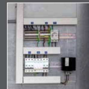
Eget EKOM-rom ved siden av LS-døren. Innvendig plass: BxHxD = 800 x 1300 x 300
