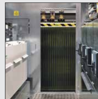
Transformator og tavle med effektbrytere.
