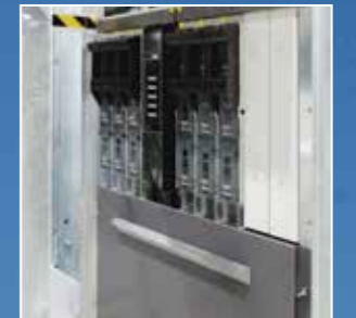
Tavle med 10 sikringsplasser
