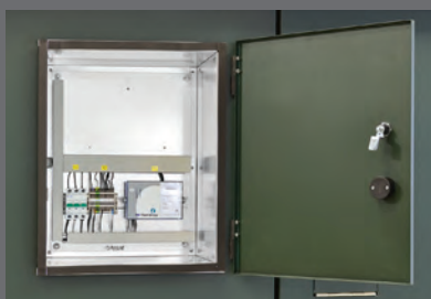
FLEX 2: Skapet er plassert i dør inn mot trafo.
