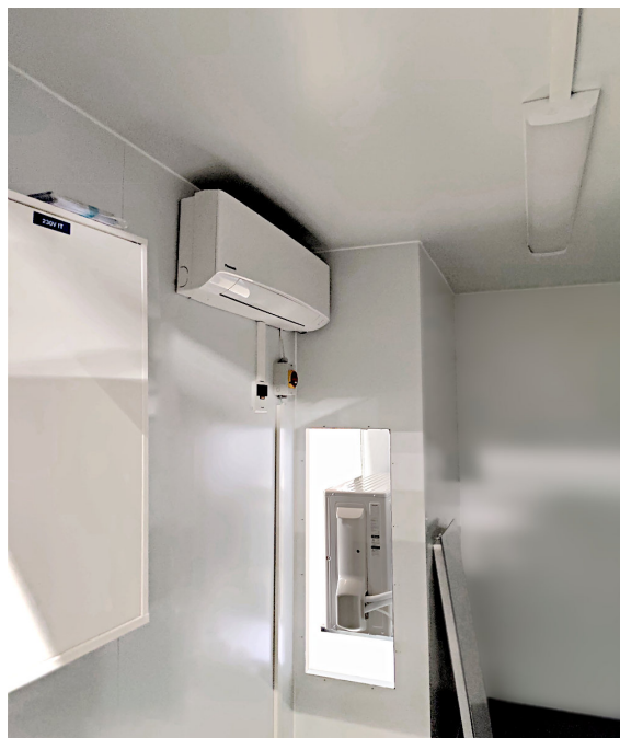
Figur 1.3: Innside av teknikkhus med AC innedel, samt inspeksjonsluke for utedel avmontert.
