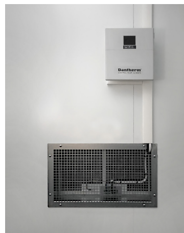
Figur 1.7: Innvendig del av frikjøler, med kontrollenhet.
